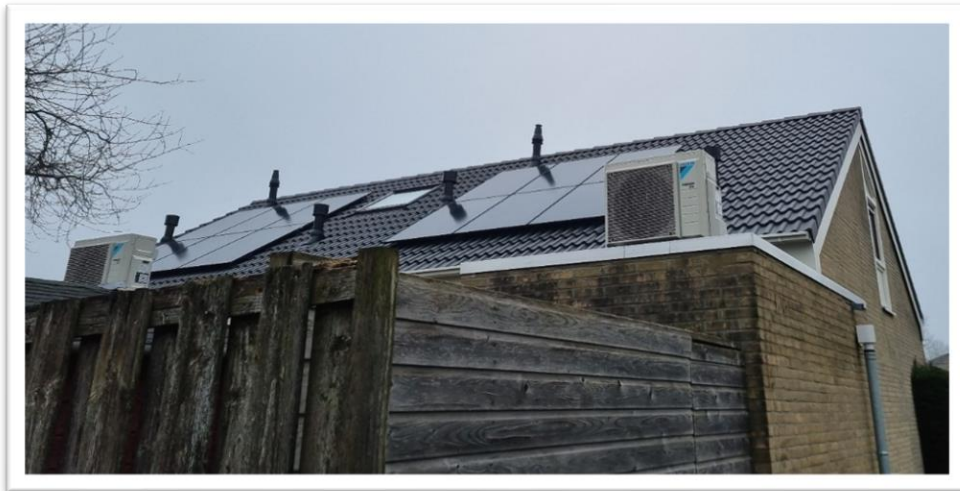
Achterzijde woningen Reidkampen met warmtepomp en zonnepanelen
